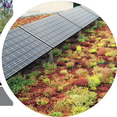
Sedumflur mit PV-Modulen
